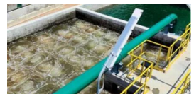
บ่อเติมอากาศและถังกระบวนการ
