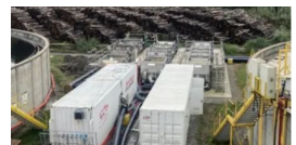
ชุดบำบัดน้ำเสียแบบเคลื่อนที่
